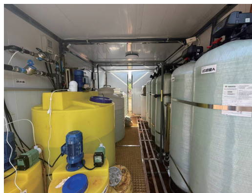
图1 高氯酸盐废水处理装置
