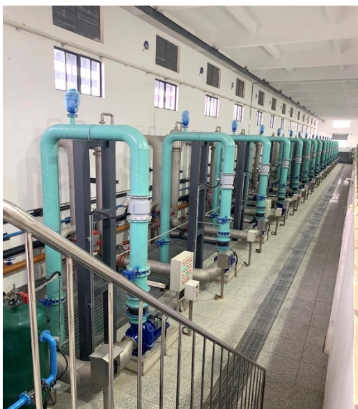
图4 北湖污水处理厂MBR膜设备间实景
