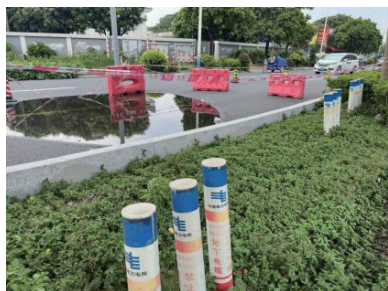
b. 道路塌陷
